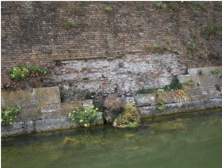
Degrado del rivestimento in laterizio dei bastioni
